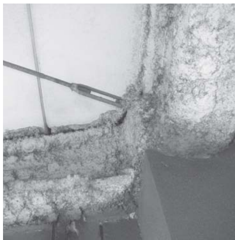
柱に吹き付けられたアスベスト含有建材
