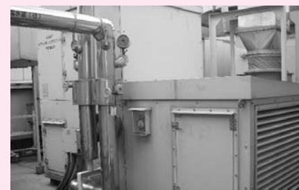
室内管理装置及び高濃度前処理室の入口(上)、給気システムの室外機(下)
