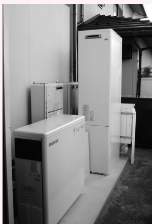
エネファームの設置状況
