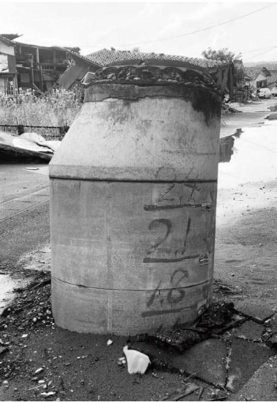
液状化で隆起したマンホール
